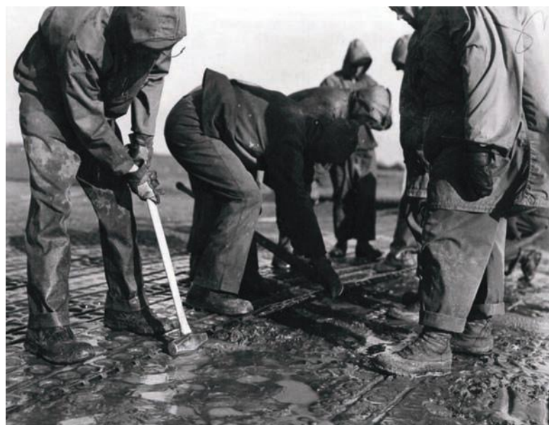
Fig.5 - Equipaggio militare durante le fasi di assemblaggio delle lastre PSP - Pierced Steel Planks (www.airspacemag.com)
